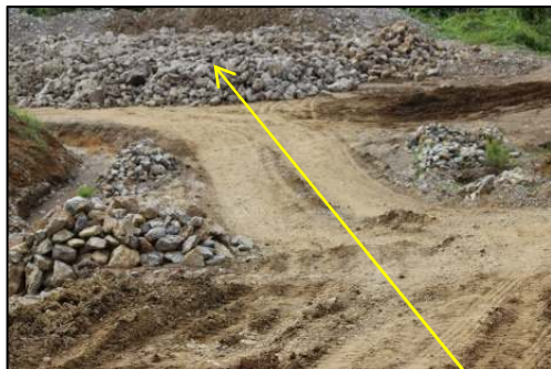
Gambar 5. Kemiringan Jalan Segmen B-C
